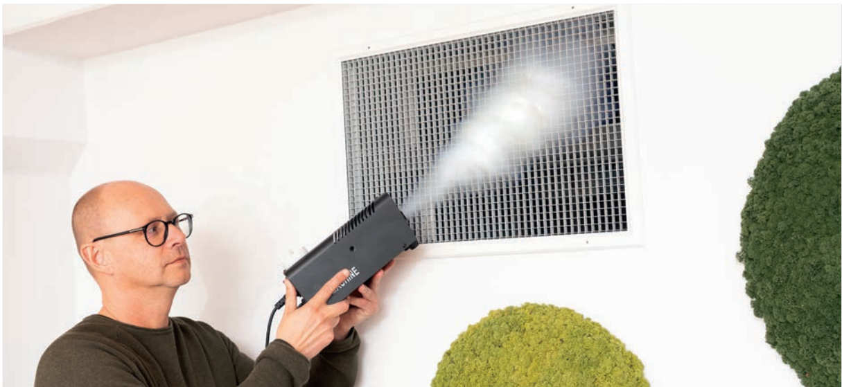
Rök (från t.ex. en rökgenerator) förs in i kanalen via frånluftsdon
